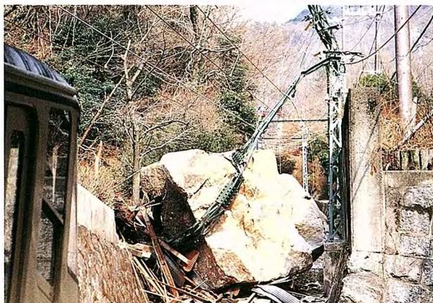
写真4 落石で破壊された六甲ケーブル
