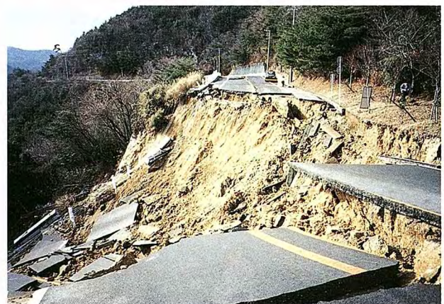
写真5 谷に崩落した芦有道路
