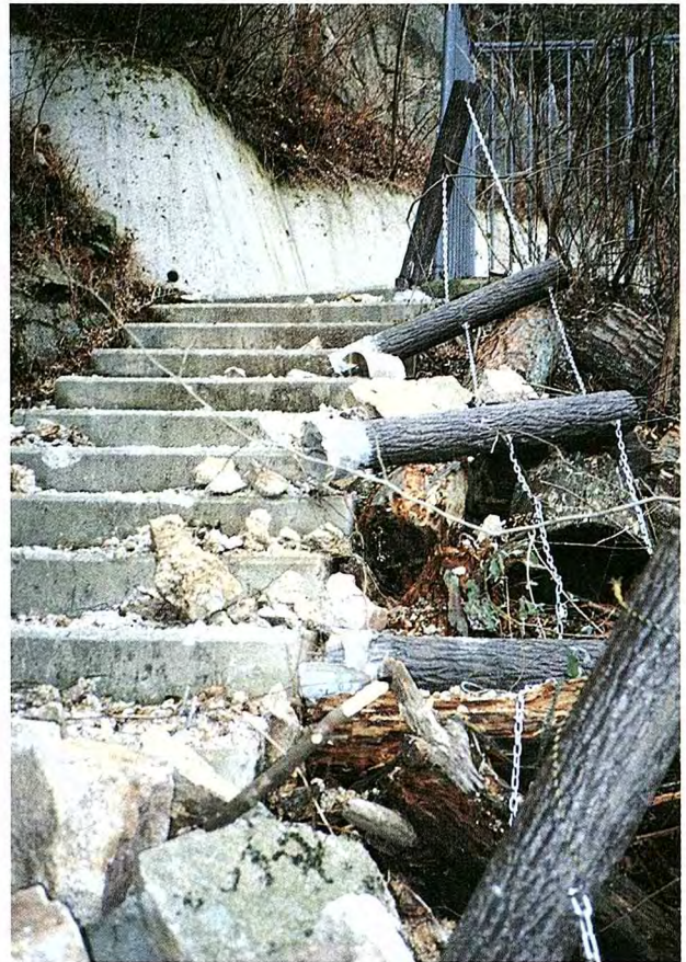
写真3 登山路柵の破損 (神戸市灘区袖谷)
