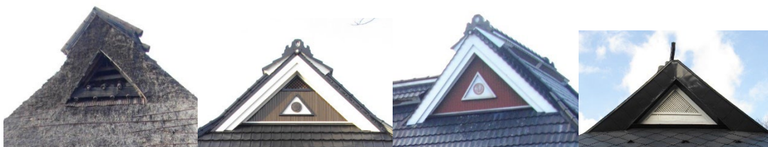
Photo. 5 西摂津 (旧有馬郡) 地域 (兵庫県神戸市北区唐櫃地区) の事例 : 左/市登録溝田家住宅
