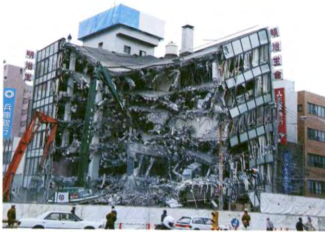
強い揺れでねじ曲がったビル（神戸市兵庫区）
