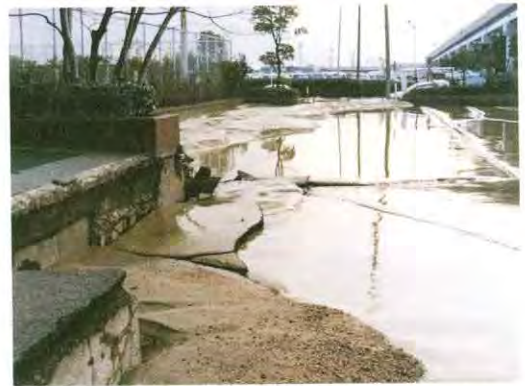
図1-9 相対沈下(約60cm)と噴砂・噴礫のようす(神戸市ポートアイランド; 溝口昭二氏提供)
