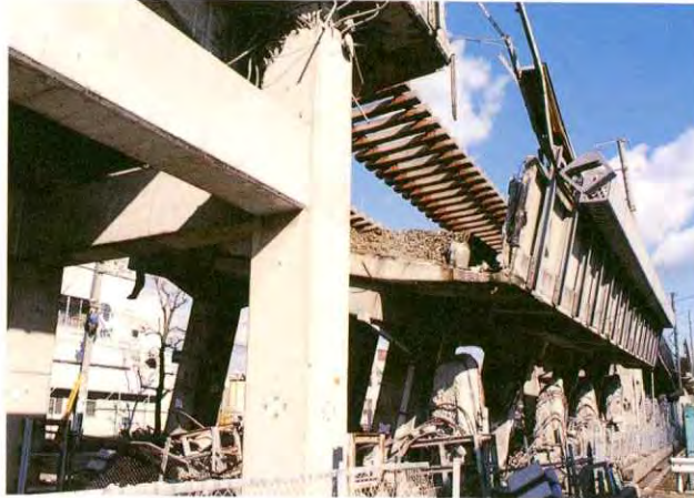
崩落した山陽新幹線の高架橋（西宮市上大市）
