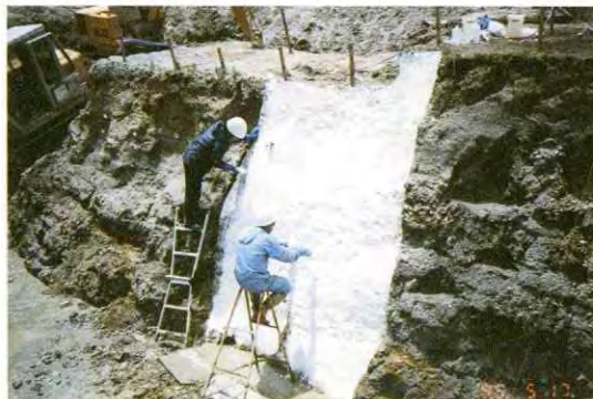
4: 水で溶いた樹脂を壁面の凹凸に塗り込み、壁面を平らにする。
